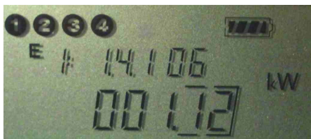
Abbildung 11: Der aktuelle Mittelwert ( 001.12 kW), die abgelaufene Messperiodenzeit MP1 (06 Minuten) und die OBIS Kennzahl E 1:1.4.1
