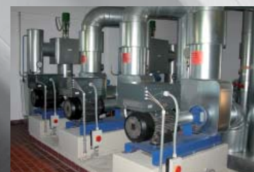
Wärmeverteilung: Mit Hilfe von modernen Pumpen wird die Wärme vom Heizkraftwerk zu den einzelnen Fernwärmekunden transportiert.
