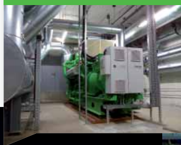
Unser Blockheizkraftwerk in der Eishalle
