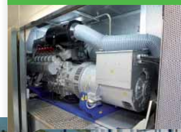
Unser Blockheizkraftwerk im Bad am Viadukt
